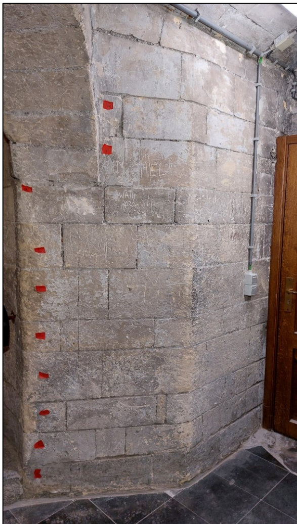
Afb. 61 (links): Gelijkvloers van de wenteltrap: muur E met veel graffiti en slijtage.
