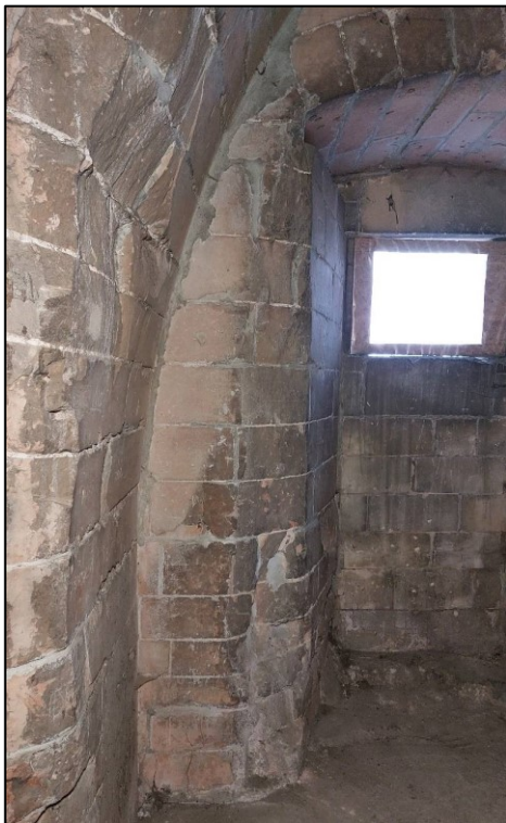
Afb. 71: Sterk afgesleten en beschadigde muur op verdieping 2 van de westtoren.
