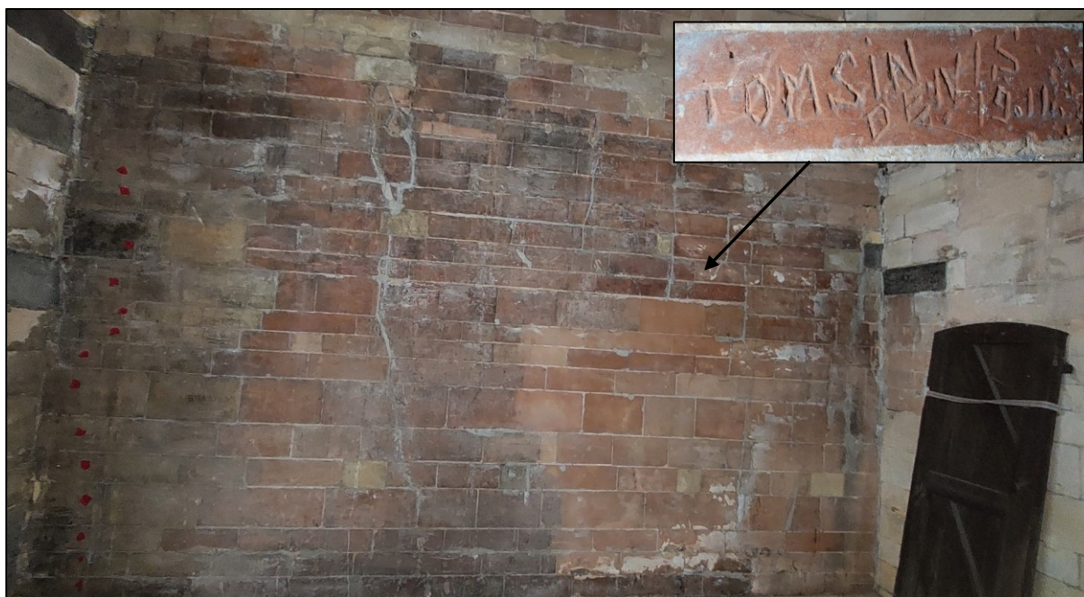
Afb. 67a: Verbrande muur I van westtoren verdiep. 1 met duidelijk lichtere brandsporen en afwezige graffiti in de linkerhoek. Afb. 67b (detail): Tomsin Denis 1911 (ID: TO-22-BOBA TOR1 (436)).
